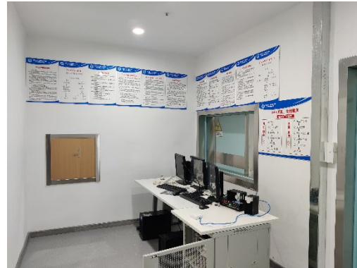
DSA 机房西北侧（控制室）
